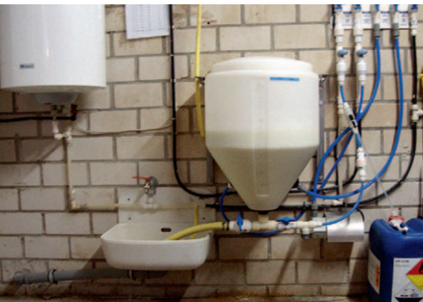
Het zenuwcentrum van supp-le-mate: een reservoir en pomp zijn geplaatst in de centrale gang.
